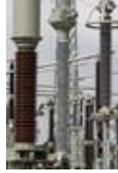
Isolatoren im Umspannwerk
