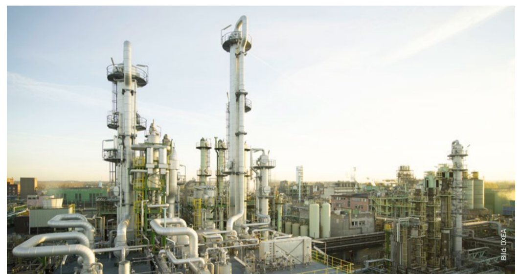
> Bei Oxea Monheim greifen jetzt alle Beteiligten auf EBS digitalen Anlagenzwilling zu
